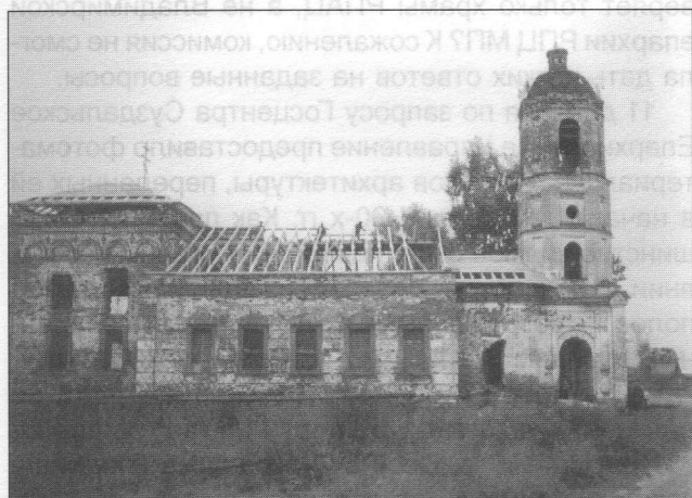
Восстановление кровли Ефремиевской церкви в с. Омутское, 1997 г. В настоящее время церкви возвращены купола на храм и колокольню, вставлены окна. Церковь оштукатурена и побелена изнутри и снаружи.
